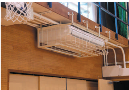
↑体育館に設置されたエアコン
